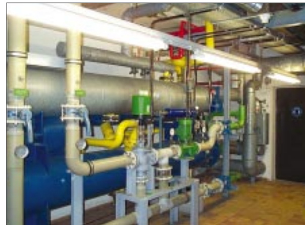
Gaswärmepumpenanlage der Stadtwerke Göppingen/EVF
